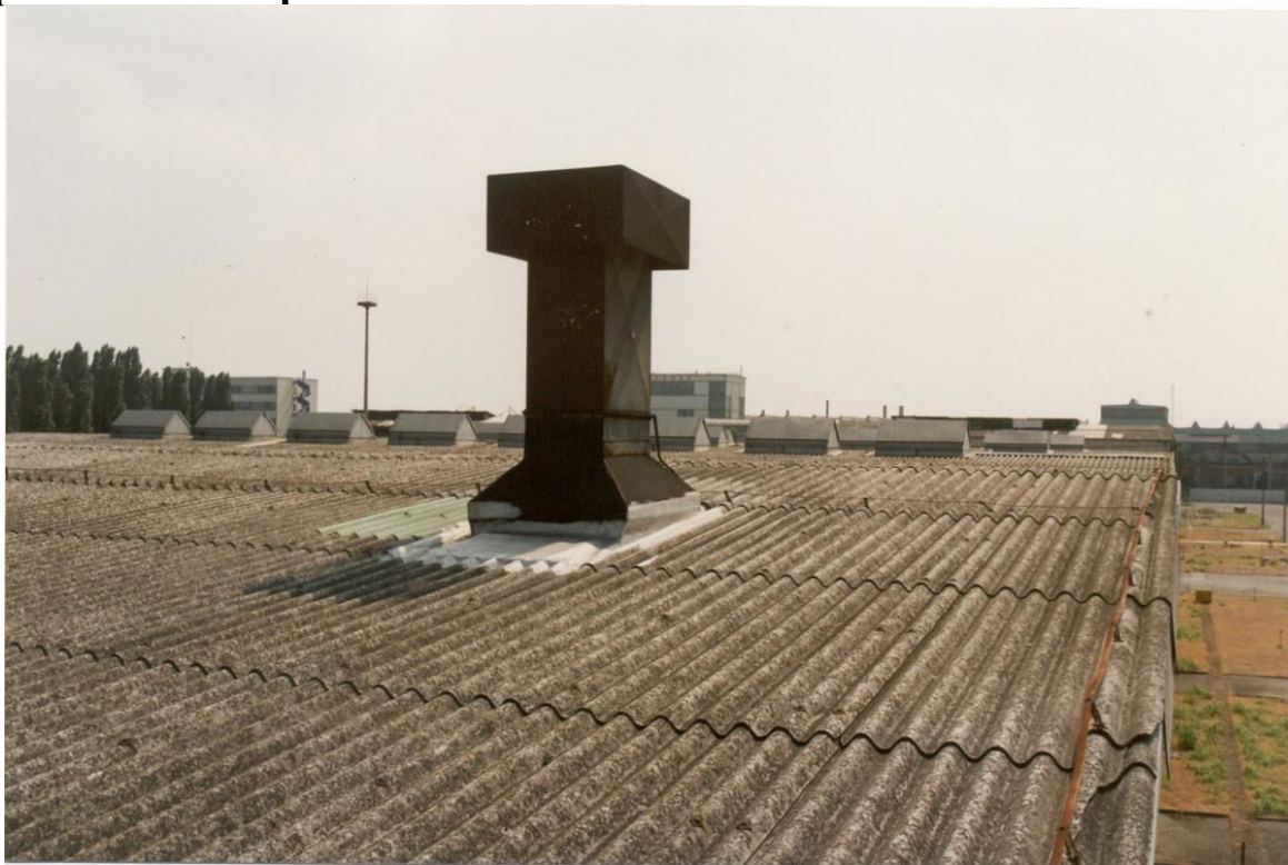
Figura B.12 – Ripresa fotografica di un particolare che illustra lo stato della copertura di un capannone industriale del Petrolchimico di Mantova
