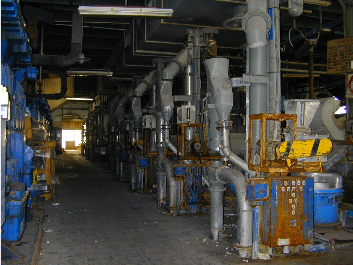
Figura D.1 – Ripresa fotografica effettuata il 16.aprile 2003 all'interno del Reparto ST9 (“Sala vecchia”) Zona scarico granuli dalle linee di estrusione
